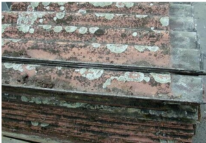
Figuur 8: asbesthoudende golfplaten
